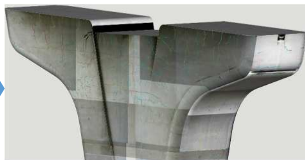
ひび割れの3次元鳥瞰図
